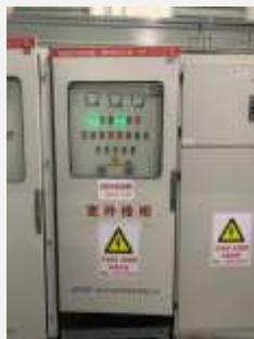
消防/喷淋泵控制柜
