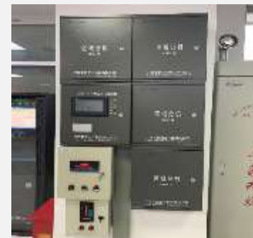
防火门控制系统
