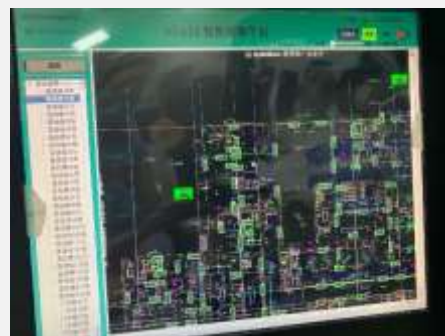
应急疏散控制系统
