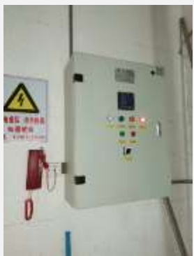
排烟风机控制柜
